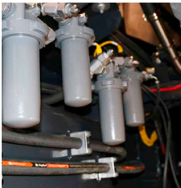
Sistema de filtrado hidráulico.
