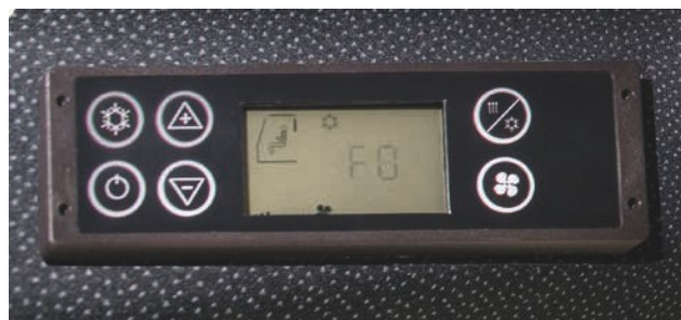
Panel de control automático de la unidad de calefacción y aire acondicionado.
