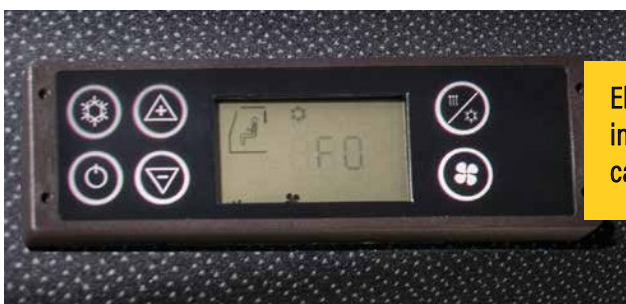
Panel de control automático de la unidad de calefacción y aire acondicionado.
